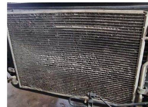
RYS. 4. SKRAPLACZ KLIMATYZACJI Z NAGROMADZONYMI ZANIECZYSZCZENIAMI
