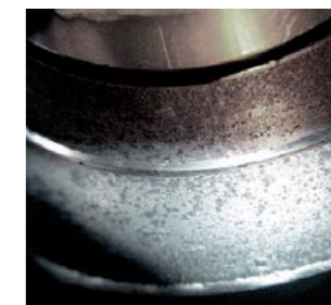
FOT. 12. WŻERY KOROZYJNE W POWIĘKSZENIU
