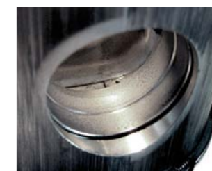
FOT. 11. WŻERY KOROZYJNE W OTWORZE PIASTY SPOWODOWANE ROZCIEŃCZENIEM OLEJEM SILNIKOWYM
