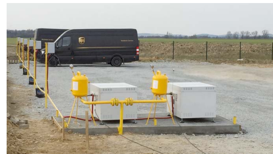
STACJA WEWNĘTRZNA CNG ZORGANIZOWANA DLA POTRZEB FLOTY LICZĄCEJ DZIESIĘĆ SAMOCHODÓW
