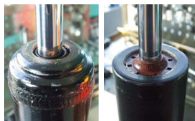
RYS. 14. SPAWANY KAPTUREK ZAMYKAJĄCY AMORTYZATOR Z WIDOCZNYMI ŚLADAMI KOROZJI
