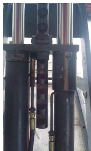
MECHANICZNE, ZĘBĄTKOWO-ZAPADKOWE ZABEZPIECZENIE POMOSTU PODNOŚNIKA NOŻYCOWEGO
