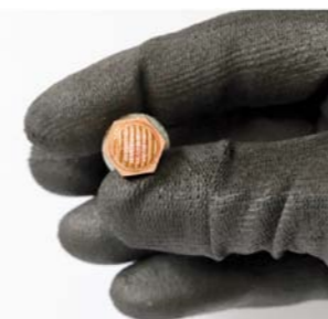
WYPALONE ZŁĄCZE ELEKTRYCZNE WYŁĄCZNIKA ELEKTROMAGNETYCZNEGO
