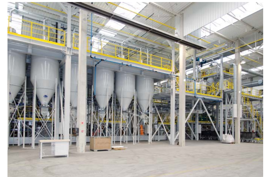
Linia technologiczna automatycznej mieszalni w nowej fabryce Lumag
