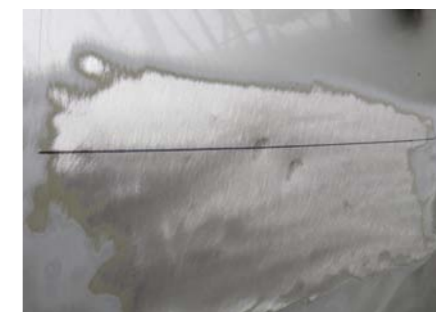
NAPRAWIANA STREFA MUSI BYĆ PRZED PODGRZANIEM OCZYSZCZONA DO GOŁEGO METALU I OZNACZONA KREDKĄ (CIEMNA POZIOMA LINIA). POZWALAJĄCĄ KONTROLOWAĆ TEMPERATURĘ
