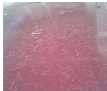
TAKI WYGLĄD POWŁOKI TO JUŻ NA SZCZĘŚCIE RZADKI WIDOK. TO EFEKT ZASTOSOWANIA BARDZO NISKIEJ JAKOŚCI MATERIAŁÓW I WIELU BŁĘDÓW PODCZAS APLIKACJI
