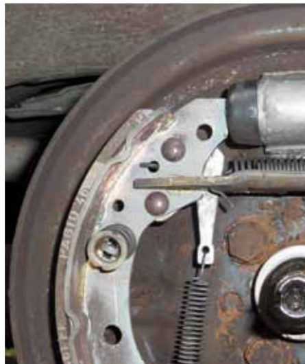
SPRAWDZENIA WYMAGAJĄ: STOPIEŃ ZUŻYCIA I EWENTUALNE USZKODZENIA AUTOMATYCZNEJ REGULACJI SZCZĘK
