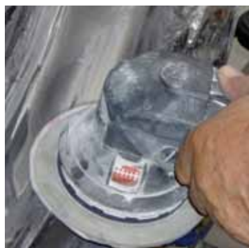
Obróbka miejsc cynowanych metodą opracowaną przez autora. Od góry: wygląd po nałożeniu cyny, formowanie zgrubne, wygładzanie
