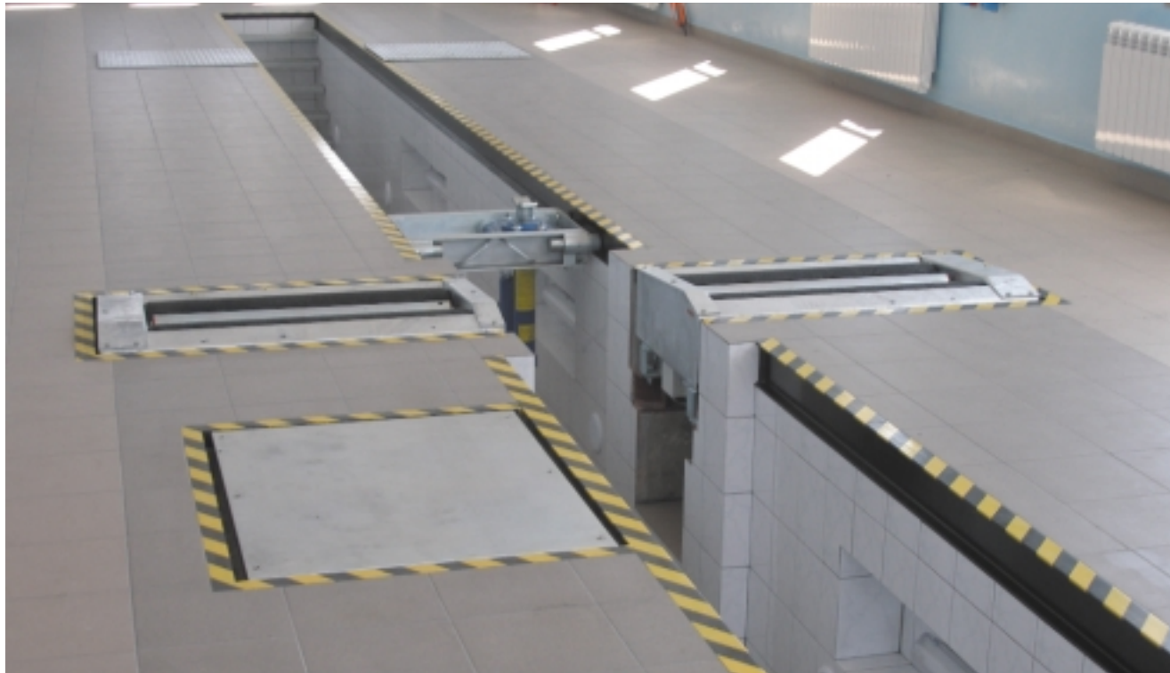
Linia diagnostyczna jest inwestycją kosztowną, ale nie zawsze konieczną
