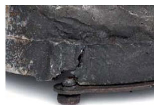
FOT. 18. PĘKNIĘCIE KORPUSU TURBINY
