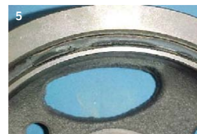
KOROZJA STALI W MIEJSCU JEJ POŁĄCZENIA Z GUMĄ
