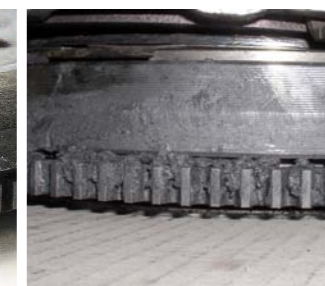
CHARAKTERYSTYCZNE OBJAWY WYCIEKU SMARU Z WNĘTRZA DKZ
