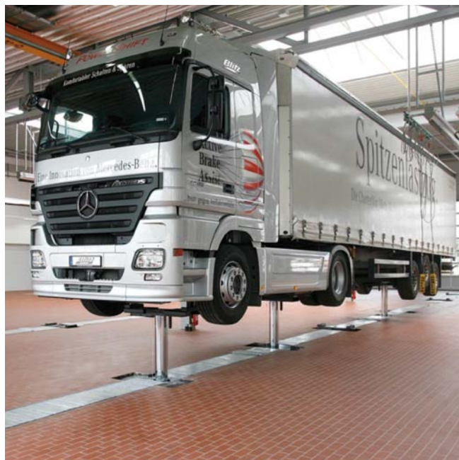
PRZYKRYTY ROLETĄ KANAŁ Z WIELOMA PODNOŚNIKAMI WSPÓLPRACUJĄCYMI W SYSTEMIE DUPLEX
