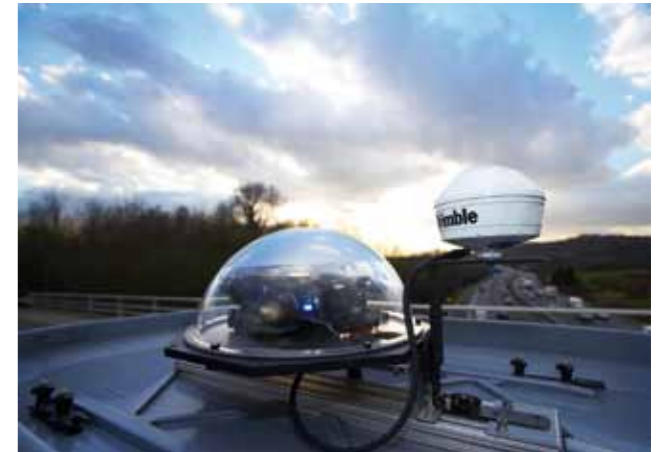
Zainstalowane na dachu obrotowe kamery wideo
