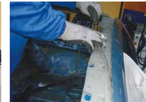
Po wycięciu wyłtoczki poszycia trzeba usunąć jej boczne ranty połączone z górnymi poziomymi belkami szkieletu
